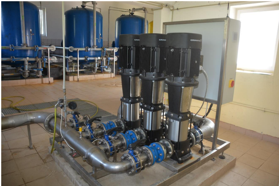
Fot. nr 32, Zestaw do podnoszenia wody SUW Sobolew (po modernizacji w 2022 roku)
