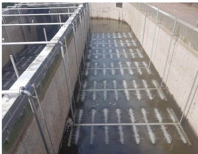
Fot. nr 40, Mechaniczno-biologiczna oczyszczalnia ścieków w Sobolewie
