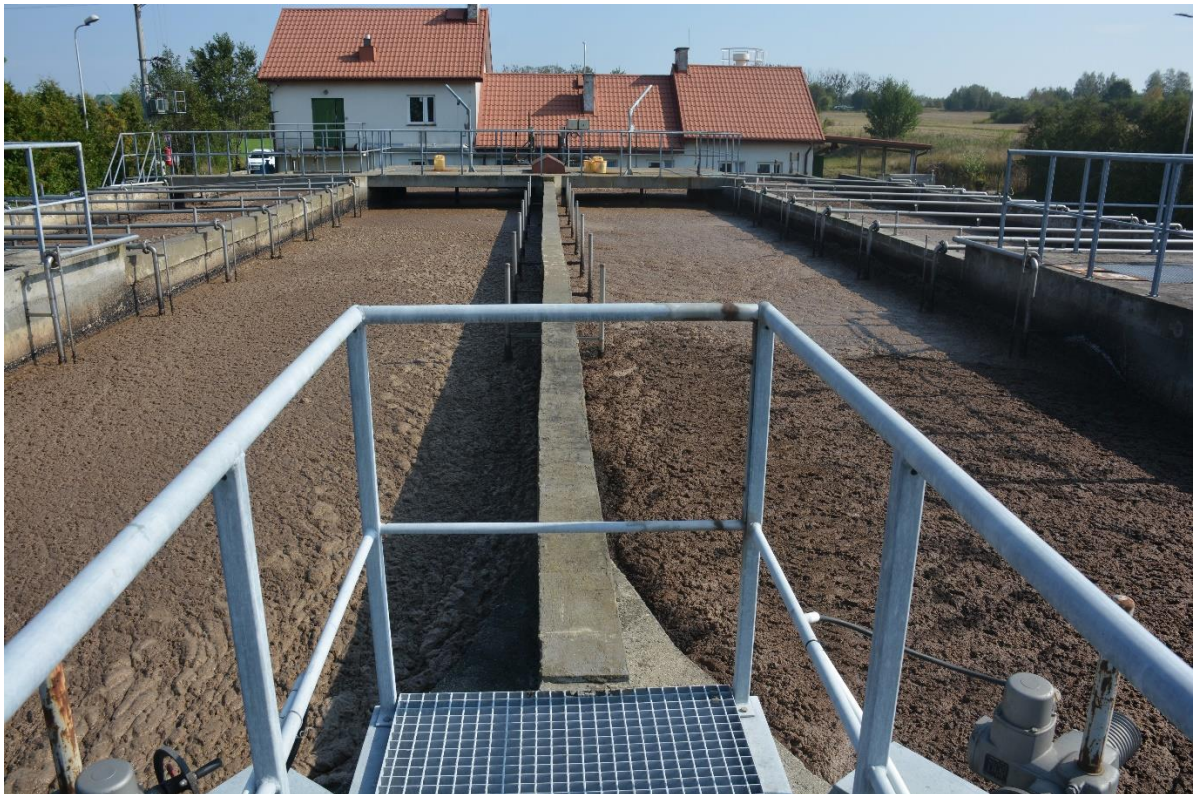
Fot. nr 44, Ciąg technologiczny komór tlenowych oczyszczalni ścieków w Sobolewie
