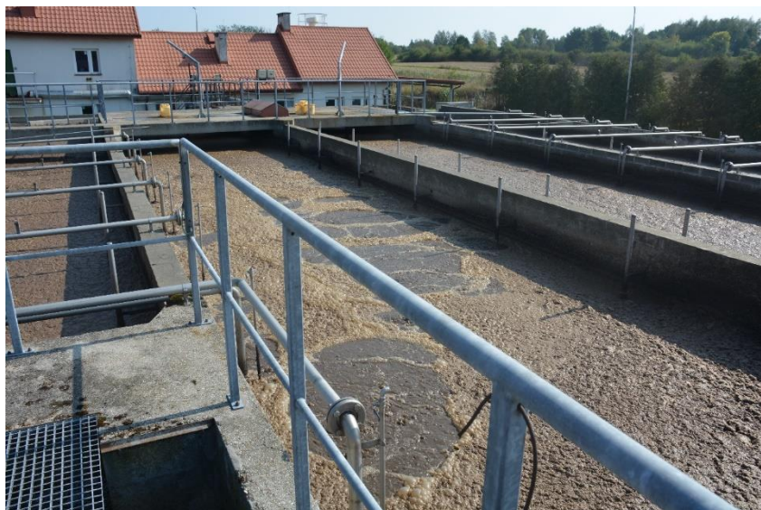
Fot. nr 45, Ciąg technologiczny komór tlenowych oczyszczalnia ścieków w Sobolewie
