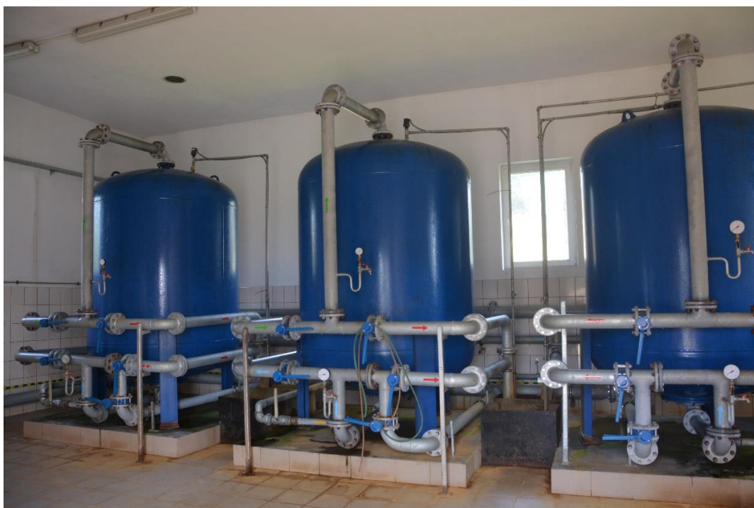
Fot. nr 31, Filtry SUW Sobolew
